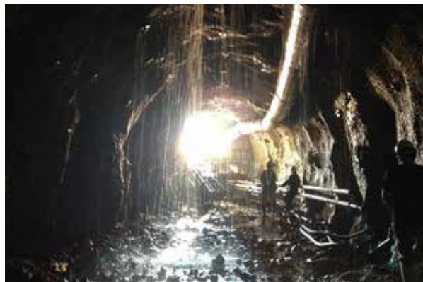
図6. 建設当初のトンネル。水漏れがひどい状態でした。
