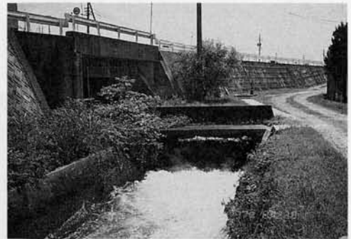
常西合口用水からの取水口
